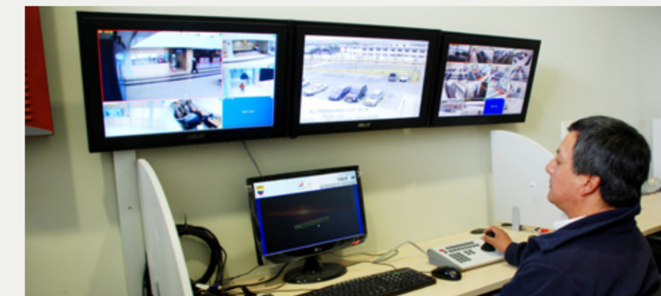
Circuito cerrado de televisión (CCTV), aeropuerto de Cotopaxi.
