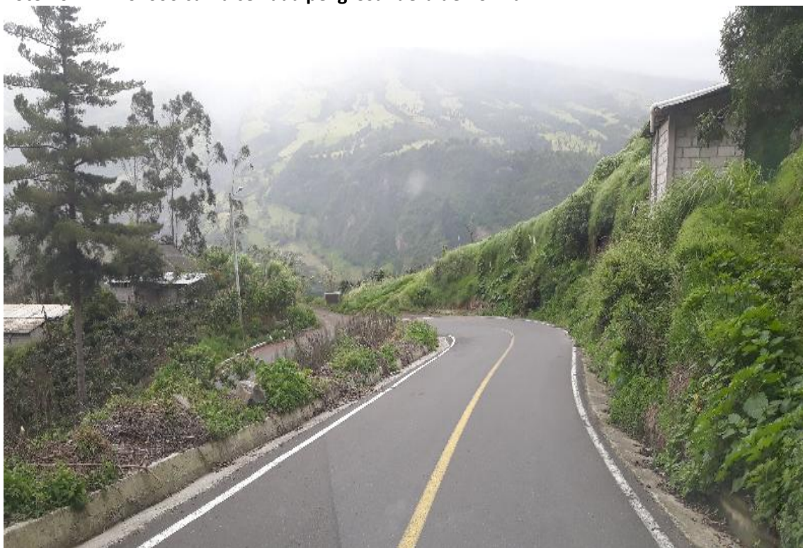
Foto 16 – Km 6+000 curva cerrada peligrosa fuera de norma.
