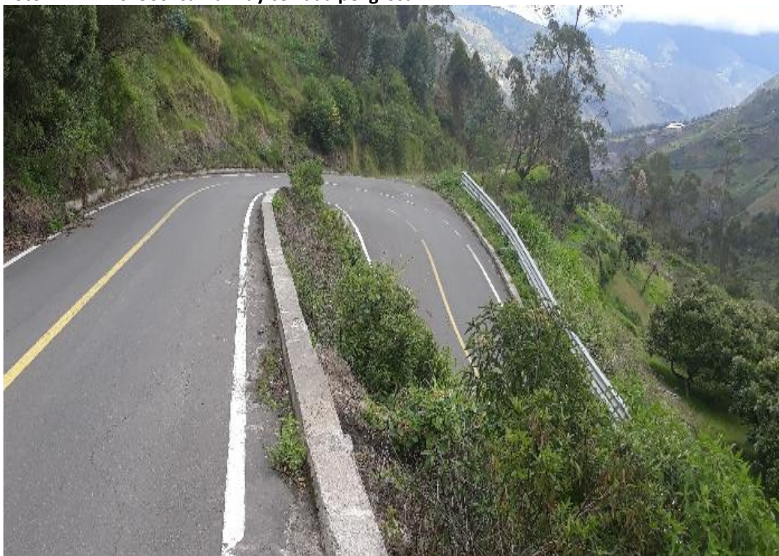
Foto 17 – Km 6+500 curva muy cerrada peligrosa.
