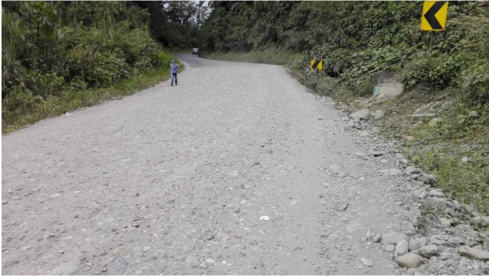
Perdida de la calzada por afloración de agua
