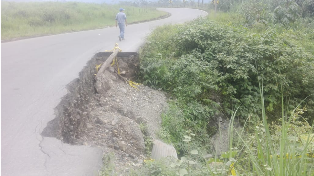
Deslizamiento de talud inferior, daños en la calzada. Falla en media luna por asentamiento
