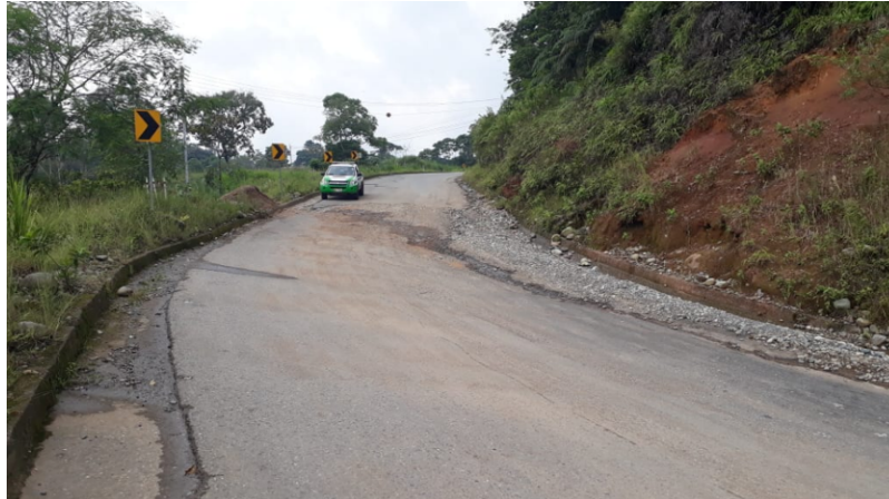
Afectación en la calzada por afloración de agua .
