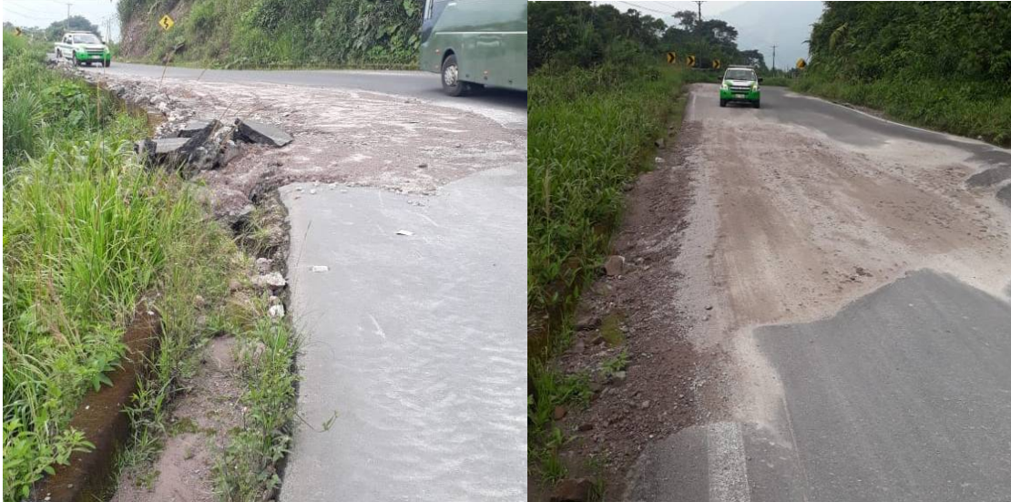
Desplazamiento y asentamiento, afectación en la calzada
