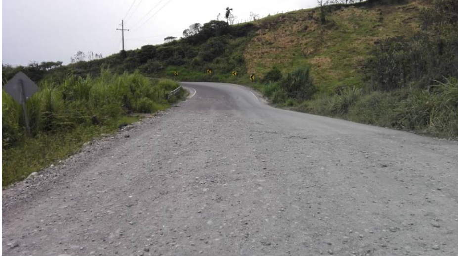
Deformación de la calzada por afloración de agua
