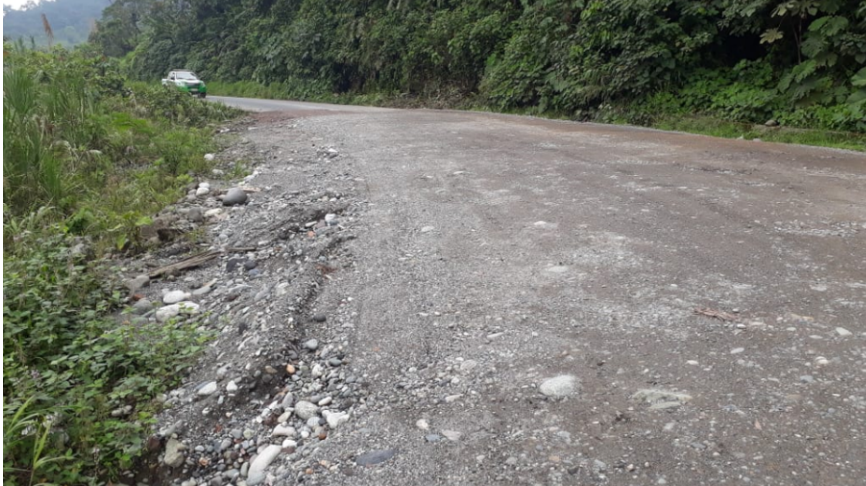
Perdida de la calzada por afloración de agua
